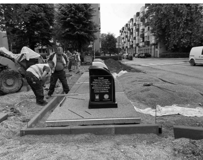
Podzemni kontejneri za razvrstavanje otpada
